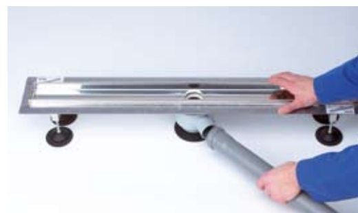
Anschluß der Abwasserleitung
